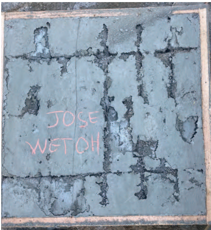
Figura 4: Panel con lanzado hacia arriba con sobredosis de acelerante durante la colocación. Cuando el concreto golpea el panel fragua inmediatamente, lo que no permite el flujo del concreto alrededor de las barras de refuerzo, lo que ocasiona huecos y vacíos atrás.
