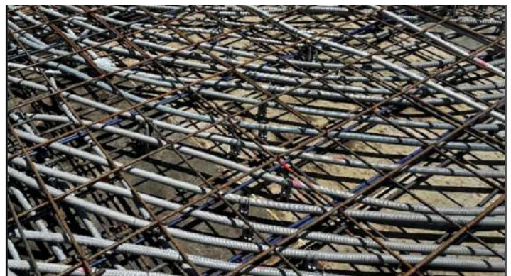
Figura 3. Un acercamiento del refuerzo. Aquí es más visible la parrilla superior de refuerzo agregado. Observe por las sombras en el conducto que muchas de éstas parecen estar a 1 pulgada (25 mm) de la cortina de la barra de refuerzo.
