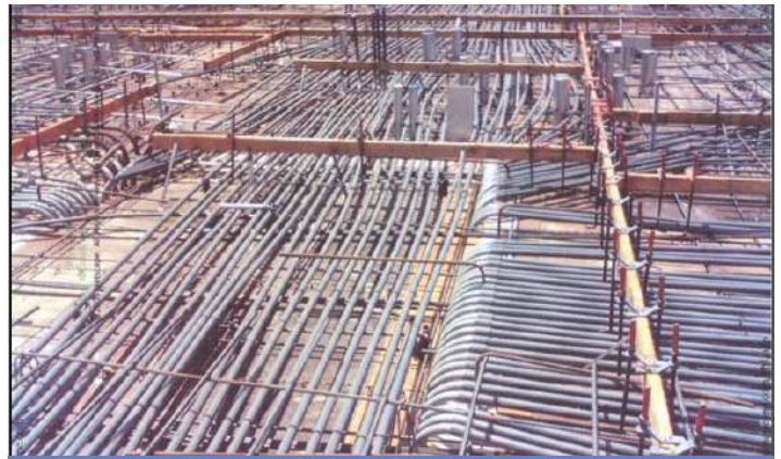
Figura 1. Un ejemplo de la congestión de conductos en una losa.
