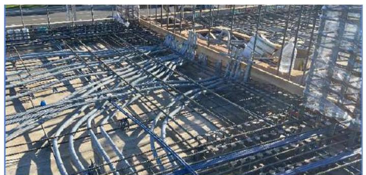
Figura 4. Un acercamiento del refuerzo en el extremo de un muro de cortante que se colará donde se encuentran las barras verticales a la derecha de la imagen (fotografía tomada en 2024). Observe por las sombras del conducto que muchos de éstos parecen estar dentro de 1 pulgada o menos de la cortina superior de la barra de refuerzo en la losa.
