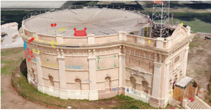
Fig. 9: Los daños exteriores pueden resaltarse en un modelo tridimensional creado mediante fotogrametría UAV.
