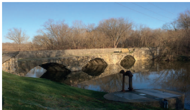
Acueducto Conococheague antes de la reparación
